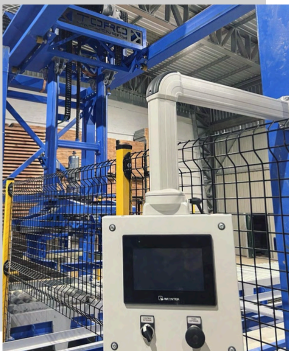
Control exterior paletizador
